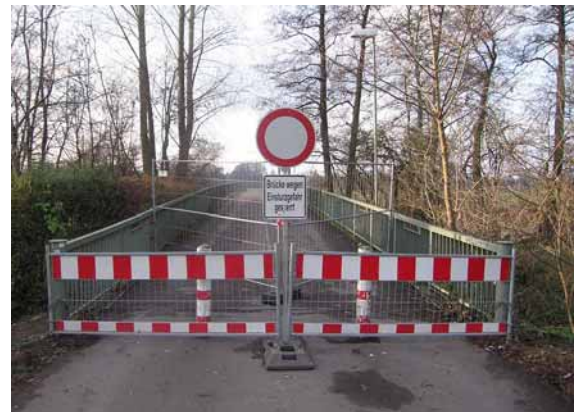
Kein Durchkommen mehr: Die Rad- und Fußwegbrücke an der Wöhrmühle
