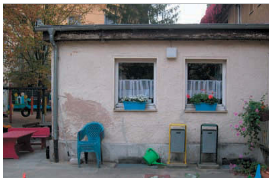
Dringend renovierungsbedürftiger Kindergarten in der Wasserturmstraße
